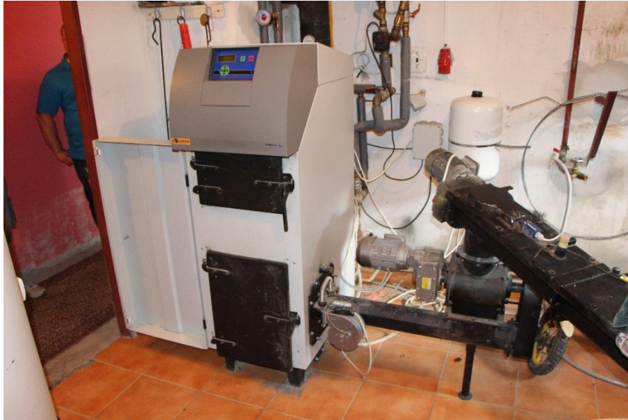
Figura 3 - Caldaia Benekov S25 con sistema di alimentazione a coclea
